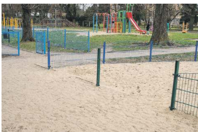
Jeżeli jest to stan ogrodzenia, który ma tak pozostać, to naszym zdaniem powinno to zostać lepiej zabezpieczone (Park Solidarności)
