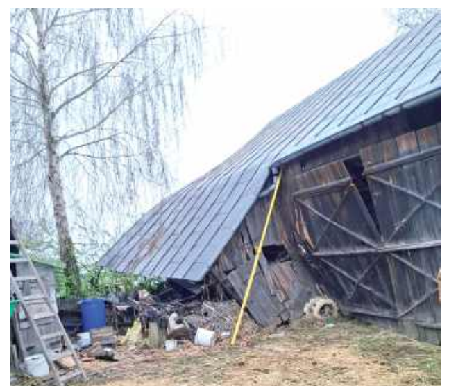
Uszkodzona przez silny wiatr stara stodoła
