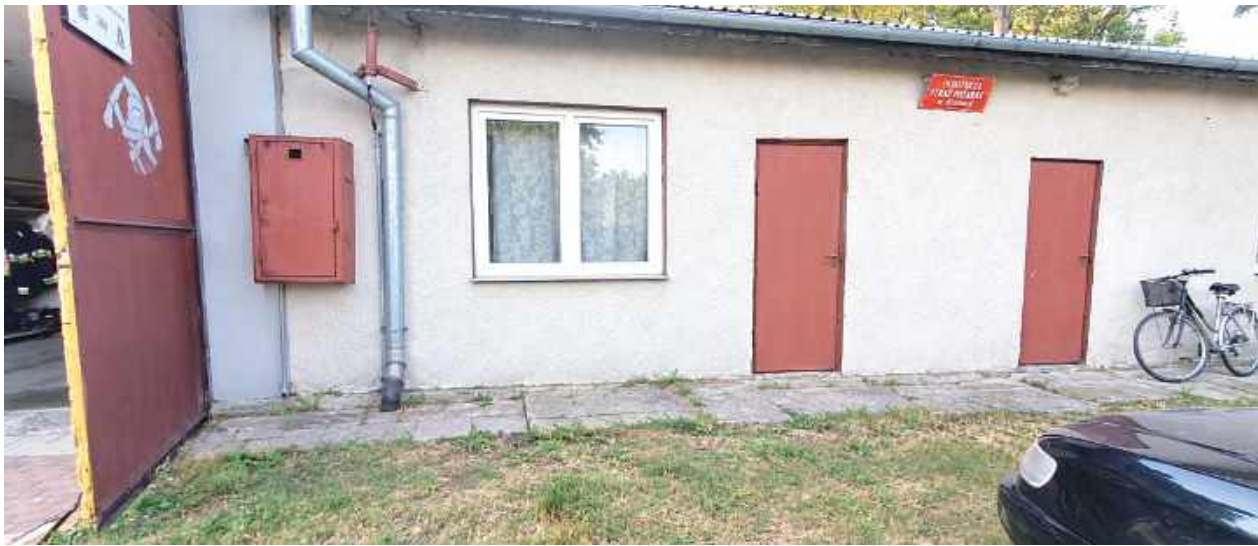
Gołym okiem widać, że remiza OSP w Kośminie wymaga remontu
