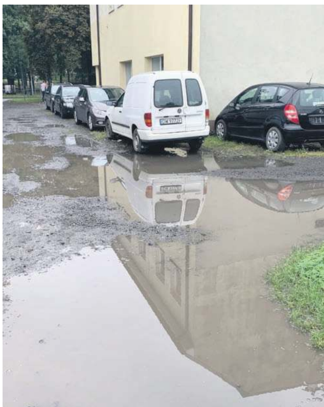
Tak po każdym większym deszczu wygląda to podwórko i wjazd na posesję
