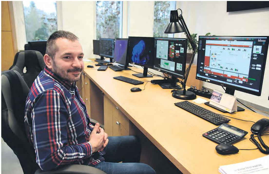
Biuro obsługi oczyszczalni to zarazem serce obiektu. Jak przyznaje Romuald Jaworski, kierownik działu automatyki dla całego PK, unowocześnienie tego miejsca pozwala na wygodną i sprawną kontrolę oczyszczalni.
