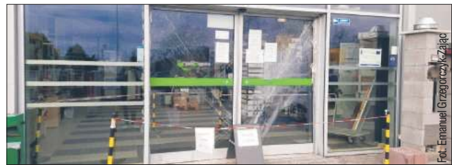
Uszkodzone przez kierowcę drzwi sklepu.
