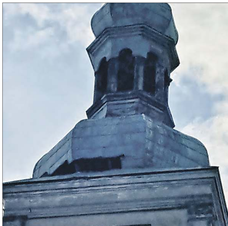
Z wieży znikają kolejne fragmenty blachy
