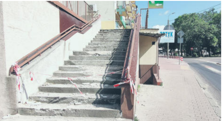
Schody do bloku przy ul. Wilczyńskiego fot. DK
