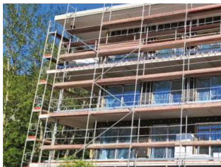
Fot. 3. Rusztowanie niewłaściwie stężone (stężenia nie stanowią układu wieżowego ani wielkopłaszczyznowego)
