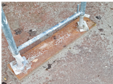
Fot. 2. Rusztowanie posadowione z wykorzystaniem uszkodzonej podstawki śrubowej
