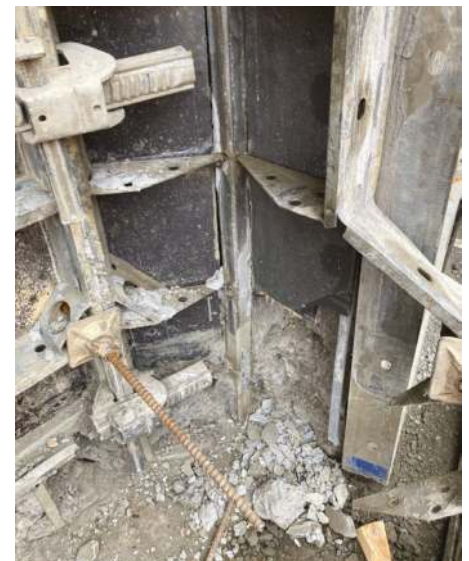
Rys. 8. Deskowanie, które uległo awarii wskutek pęknięcia ściału szalunkowego (główną przyczyną zdarzenia były błędy montażowe, skutkujące znacznym przeciążeniem elementu ściągającego)
