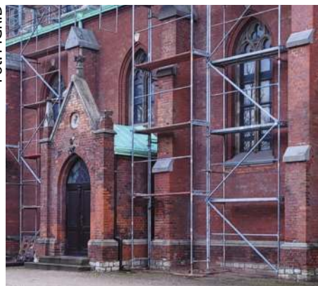
Fot. 4. Rusztowanie bez kompletnych balustrad (brak poręczy pośrednich i krawężników)
