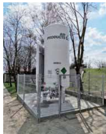
Nowa instalacja tlenowa
