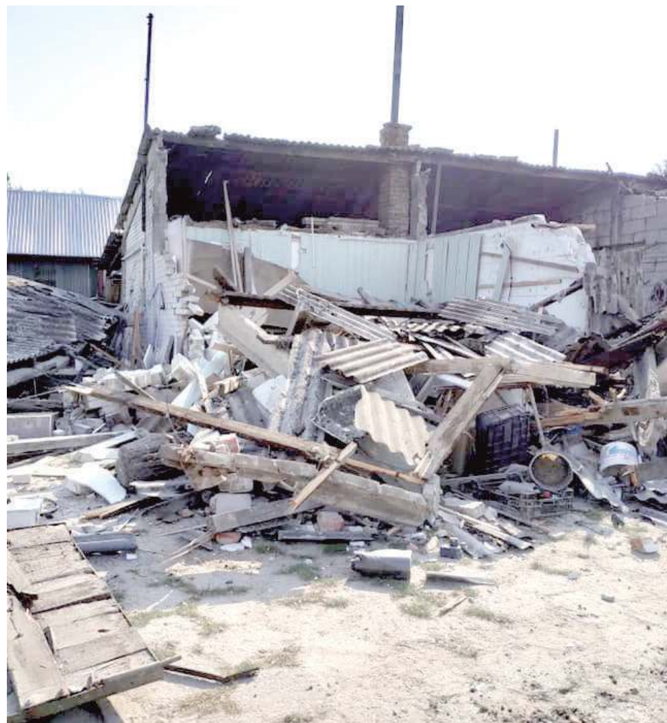
Taki widok zastał na miejscu właściciel zakładu kamieniarskiego
