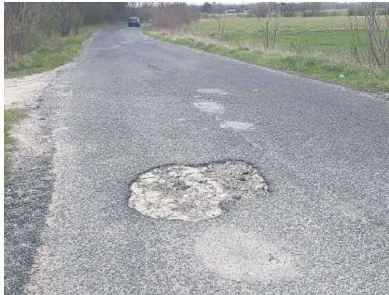
Fragment gminnej drogi w Łukówku Kolonii już wymaga naprawy
