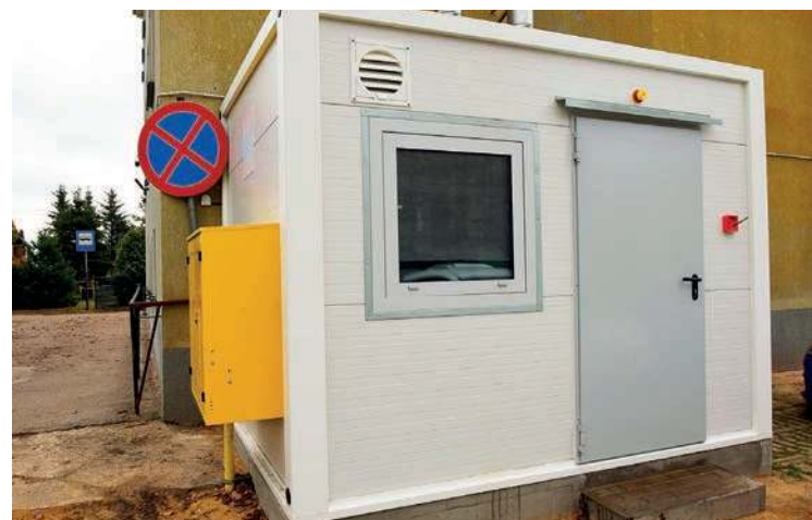
Kontener dla nowych kotłów gazowych
