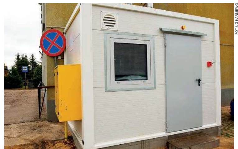
Kontener dla nowych kotłów gazowych
