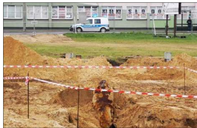
Podczas prac budowlanych związanych z powstaniem stacji paliw przy ul. Sidorskiej 61, znaleziono niewybuchy z okresu II wojny światowej
