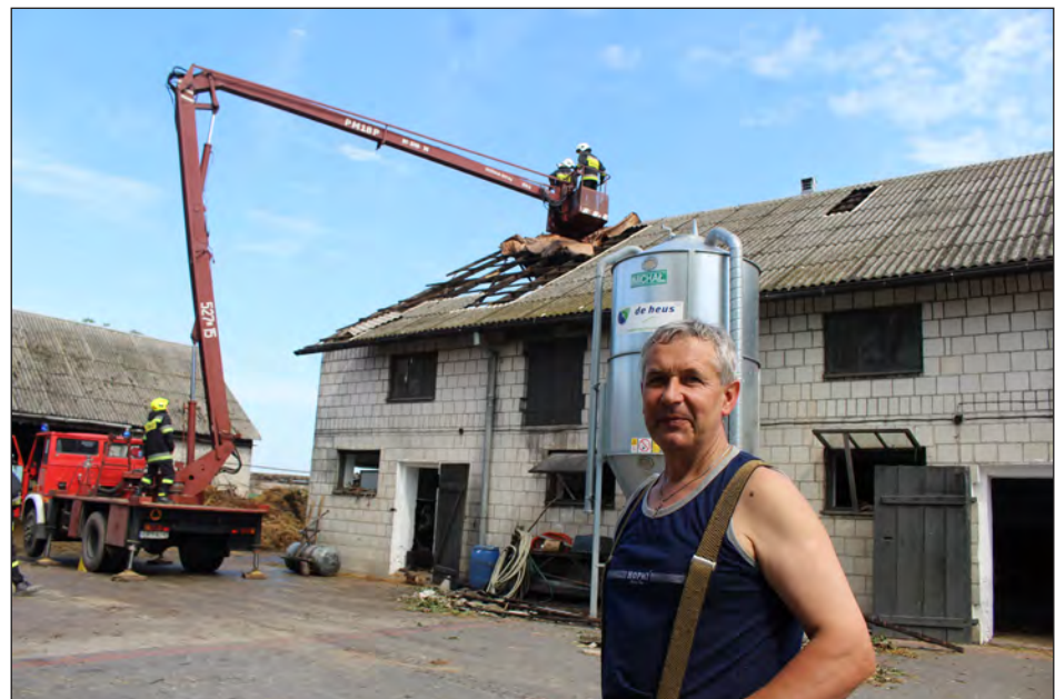
✚ - Kiedy pobiegłem zamykać drzwi w obejściu zrobiło się niebiesko i zaraz potem zaczęło sypać gradem. Kilka kulek uderzyło mnie boleśnie w dłoń, a z obory zerwało część dachu - mówi Jerzy Grzyb
