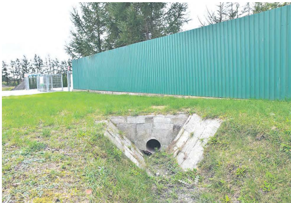
Wody opadowe z jednej strony jezdni poprowadzone są pod drogą na drugą stronę. Tam wylewają się z rowu melioracyjnego i dalej zalewają tereny należące do pana Łukasza. Fot. (kt)
