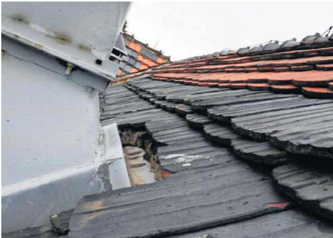
Zniszczony dach kościoła Najświętszego Serca Pana Jezusa w Jastrzębiu-Zdroju
