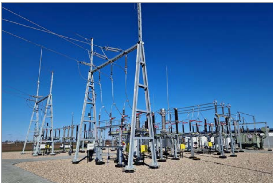
Transformacja energetyczna i rozwój przemysłu powodują, że system elektroenergetyczny funkcjonuje dziś w warunkach znacznie większej zmienności niż jeszcze kilka lat temu
