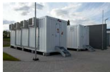
Zdjęcie z realizacji BESS 1 MW/2 MWh
