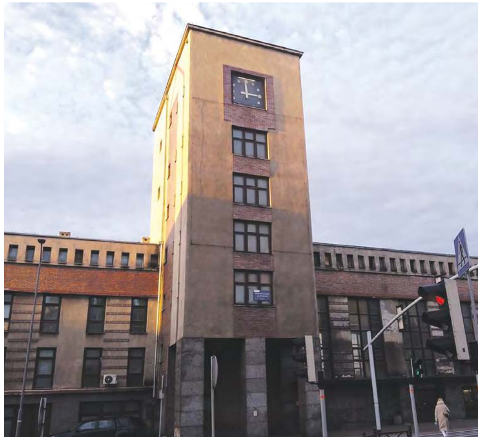
Odnowy doczeka się między innymi zabrudzona elewacja
