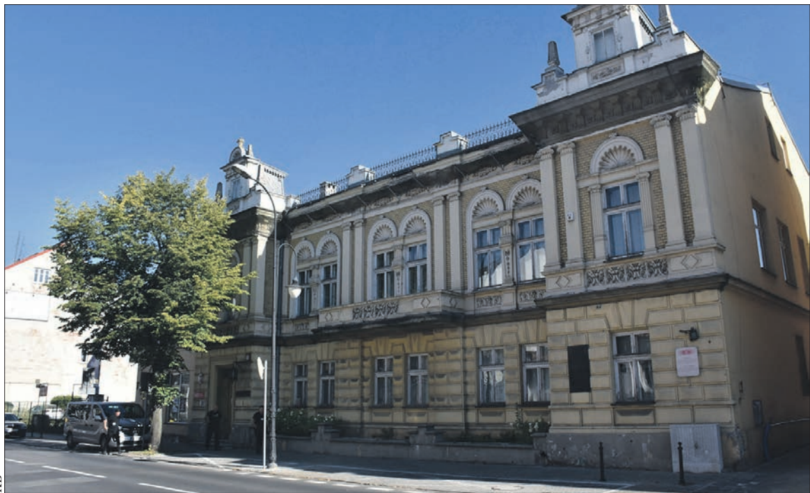
KB Zabytkowy budynek USC wymaga prac remontowych i konserwatorskich
