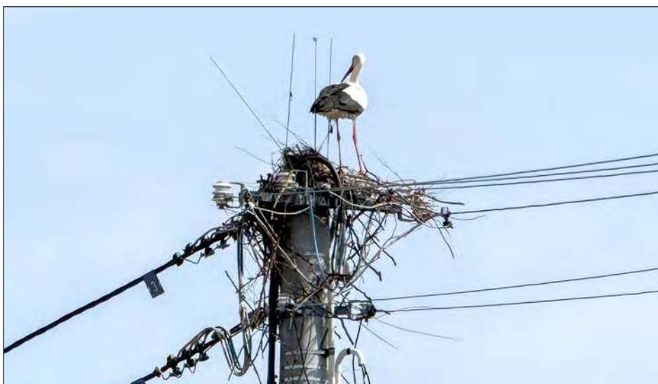
■ Bociany nie odpuszczają, ale z powodu zamocowanych prętów nie mogą odbudować gniazda
