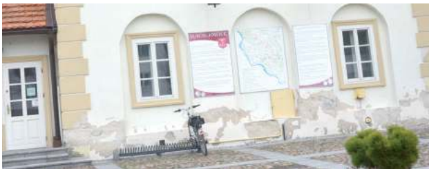
Tak obecnie wygląda fragment elewacji ratusza w Maciejowicach
