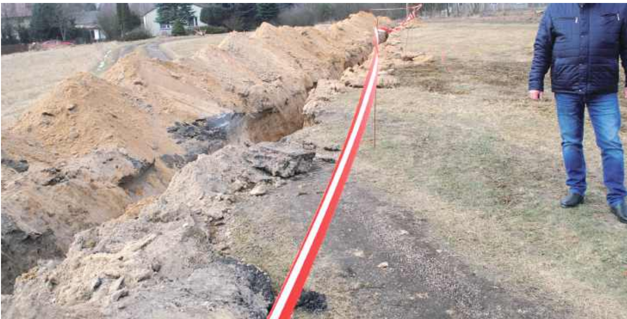
Wykop w drodze uniemożliwia dojazd do posesji
