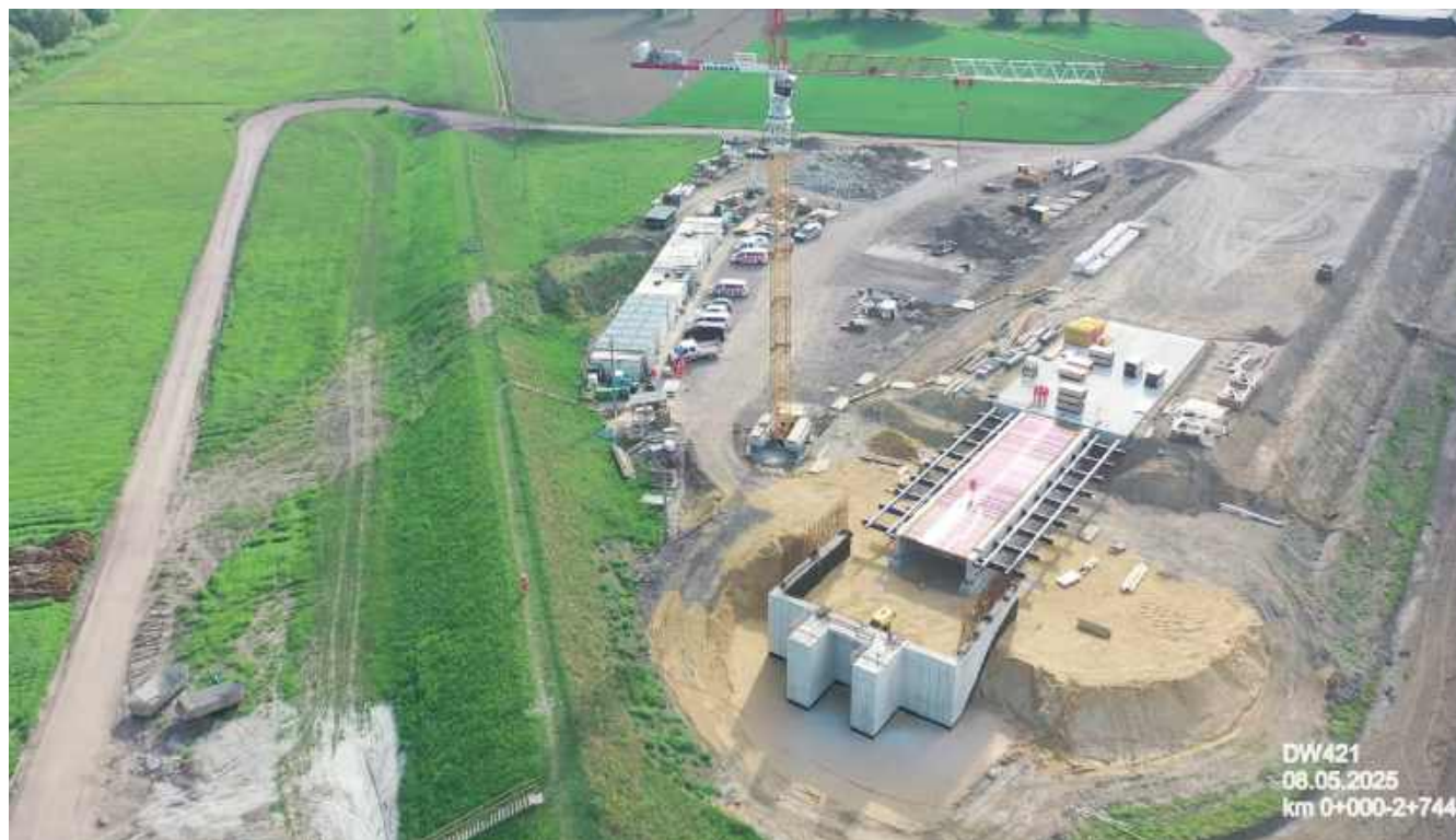
■ Prace przy budowie trwają na kilku frontach, a most o długości 633,6 metra z 13 przęsłami ma zostać ukończony do 2027 roku. FOT. DW421.PL
