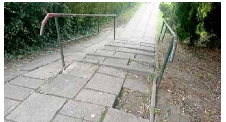
Schody są w fatalnym stanie
