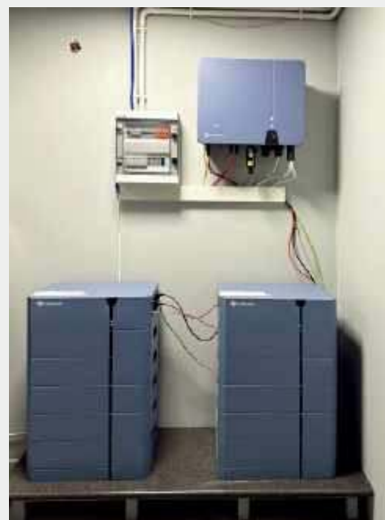
Instalacja hybrydowa Solplanet wykonana przez firmę DORJAN-ENERGIA
