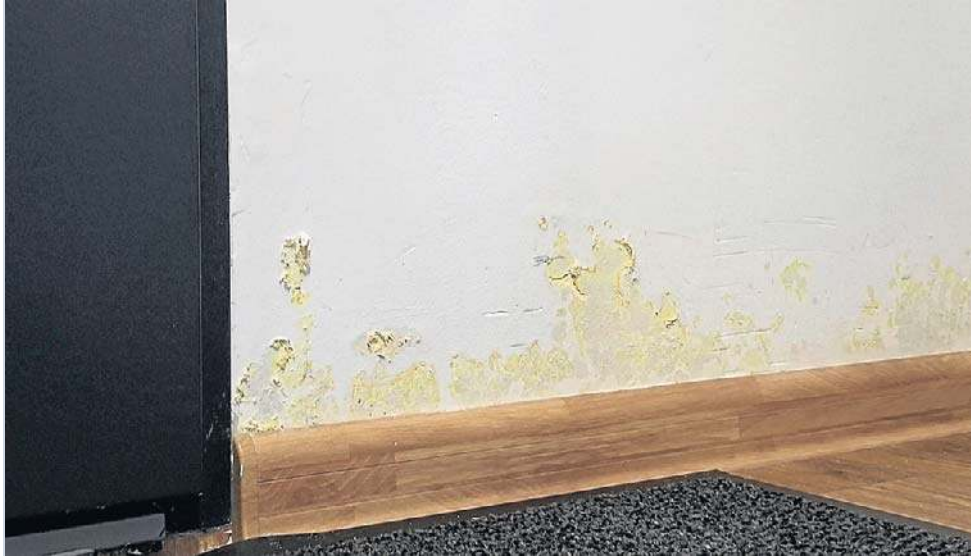
W jednym z mieszkań na zawilgoconej ścianie zaczyna odpadać farba
