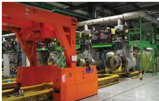
Fot. 3. Wyposażenie hali testowania urządzeń kriogenicznych.
