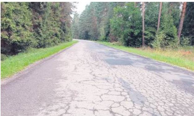
Droga jest w fatalnym stanie.
