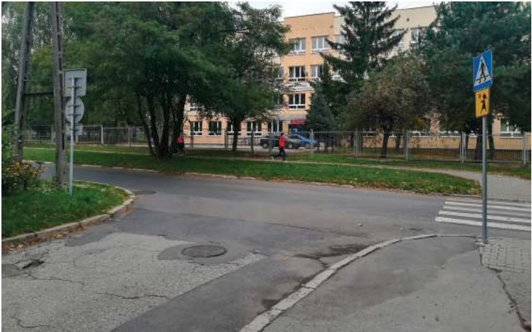
Kierowcy z Bazylianówki skarżą się na asfaltowe garby na jezdniach narażające zawieszenia ich aut na uszkodzenia
