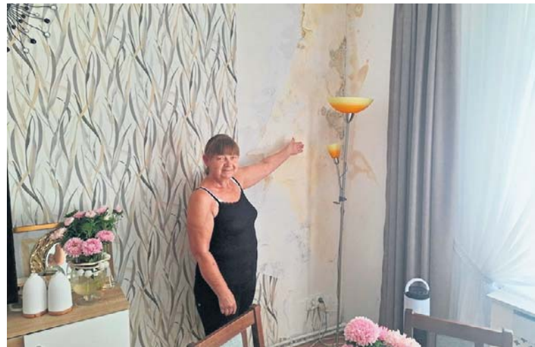
Elżbieta Szekal przy zalanym, zawilgoconym narożniku w pokoju
