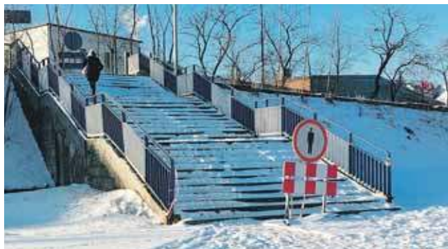
Schody zostały zamknięte ze względu na ich zły stan techniczny
