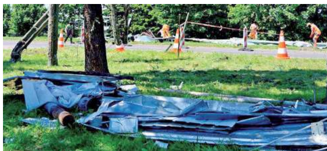
Wichura urwała dach w siedzibie GDDKiA w Międzyrzeczu Podlaskim
