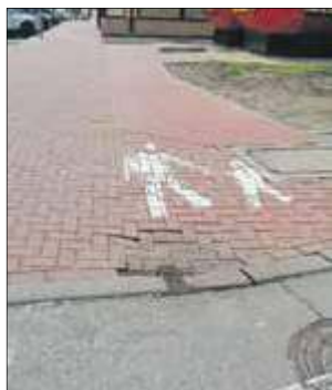
Za pośrednictwem radnego Jakubca mieszkaniec zgłaszał zapadnięty chodnik do naprawy już w kwietniu...
