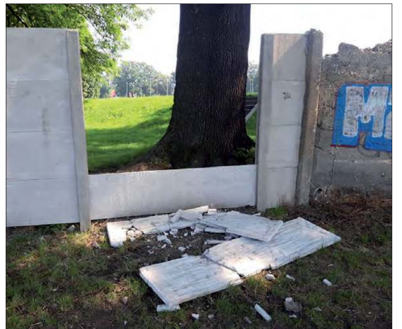
Zniszczone ogrodzenie stadionu
