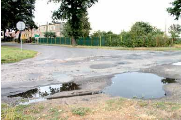
Droga w Strzyżnie przy skrzyżowaniu jest pełna dziur.
