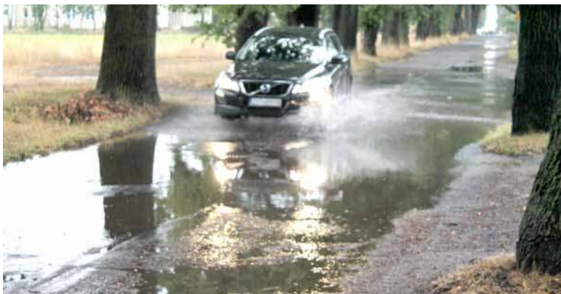
Jak widać na zdjęciu na ulicy Niemcewicz jazda samochodem przypomina rajd. UM zapowiada odwodnienie drogi i miejscowe łatanie dziur. Kierowcy trzymają za słowo
