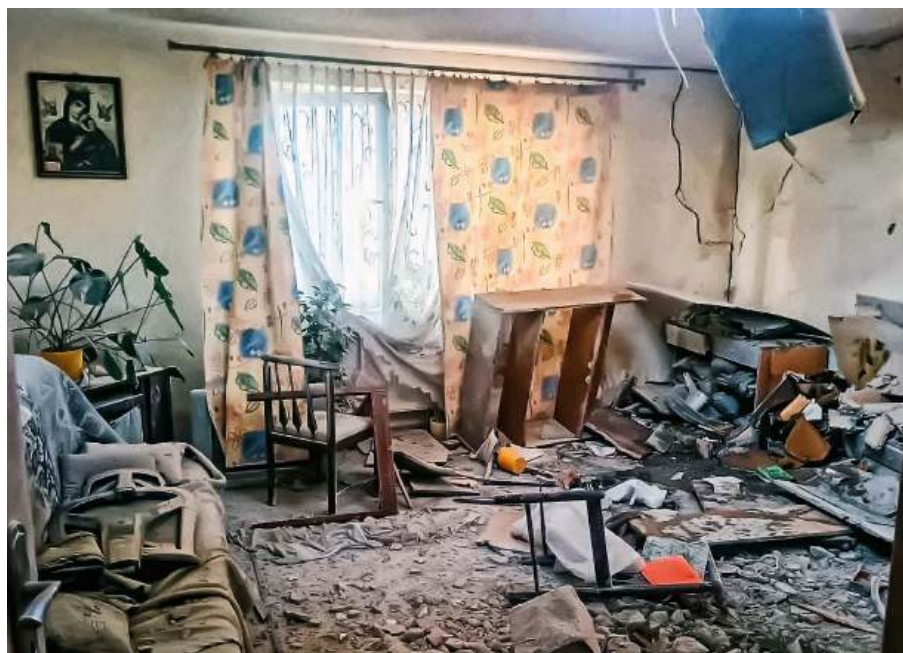
Dom w Wyrkach, który został uszkodzony przez „niezidentyfikowany obiekt latający”
