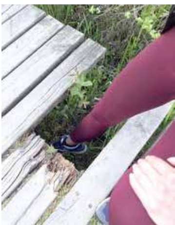
Widoczne zniszczenia są coraz poważniejsze
