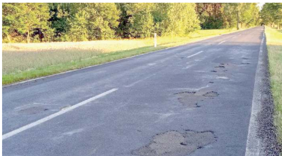
DW 820 w rejonie Starego Orzechowa jest w opłakanym stanie, ale ma się to zmienić
