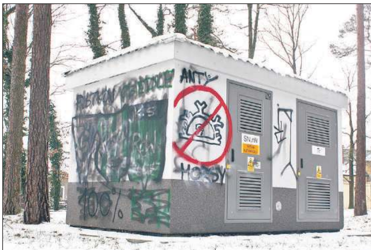
Część graffiti na rozdzielni prądu zostało pomazane czarną farbą.
