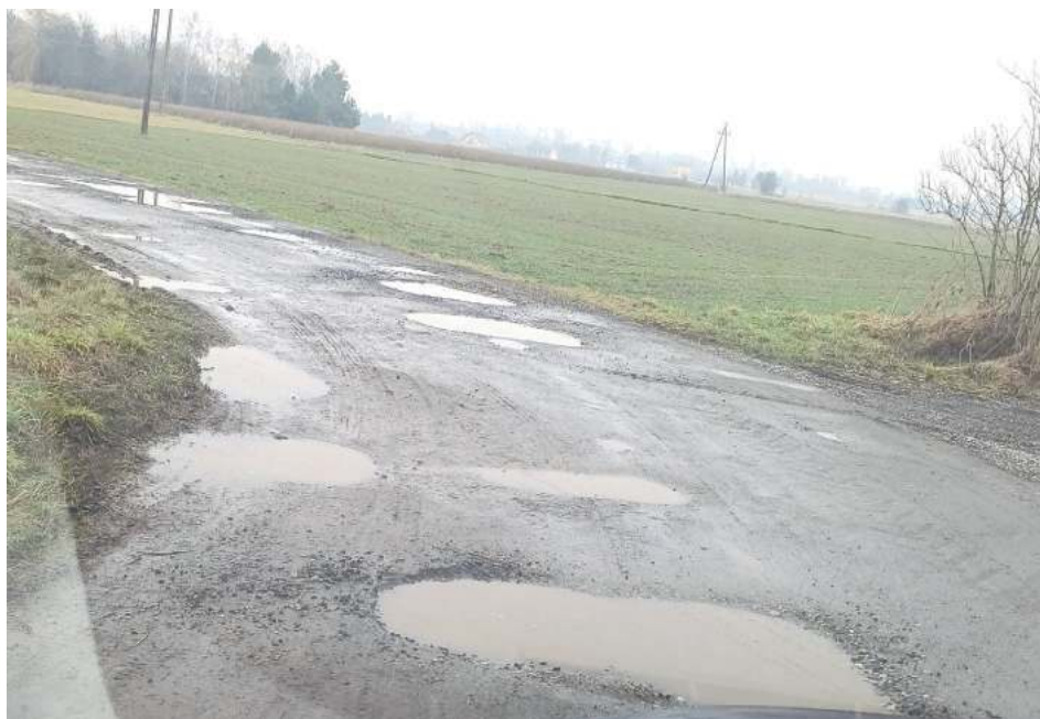
Tak prezentuje się droga gminna między Łeką a Bronowicami. Mieszkańcy liczą na to, że odcinek zostanie w końcu pokryty asfaltem
