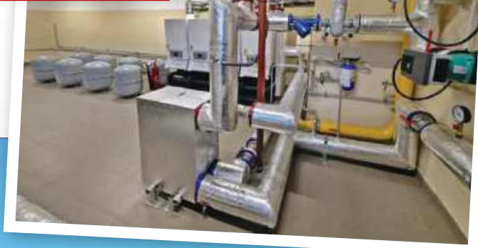
Kotłownia należąca do zasobów Spółdzielni Mieszkaniowej „Marcel”. Spółdzielnia stopniowo modernizuje instalacje grzewcze w swoich budynkach.
