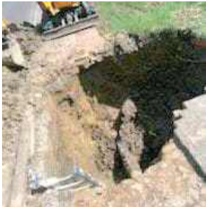
W tym wykopie na konserwatora zawaliła się ziemia
