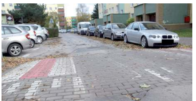
Jest to jedna z ostatnich dróg w mieście, która potrzebuje pilnej przebudowy
