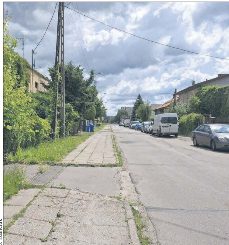
Część ulicy Lasockiego wymaga remontu
