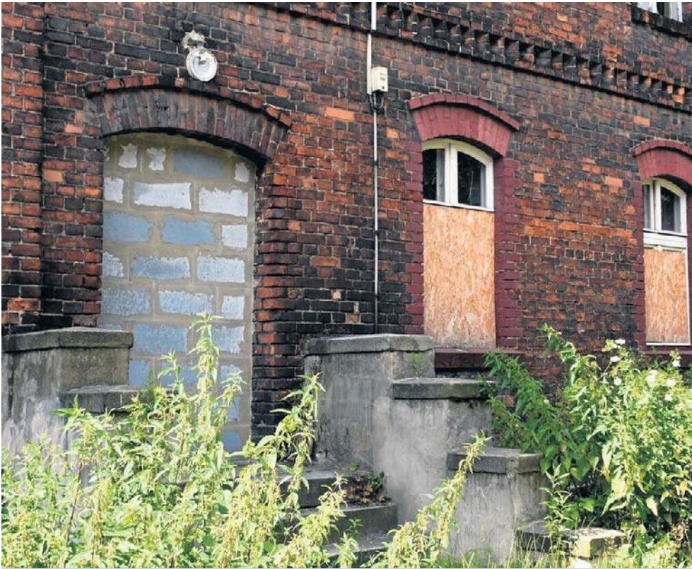
Opuszczone mieszkania w familoku przy ulicy Przemysłowej.
