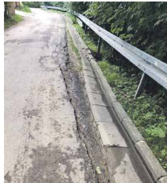
Zniszczony asfalt na ul. Gładkie.
