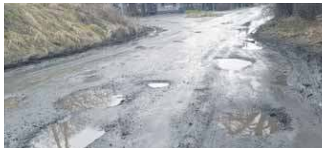
Ulica Dworcowa w Wieszowie. Pieszko czy samochodem – pokonanie jej to przeprawa
