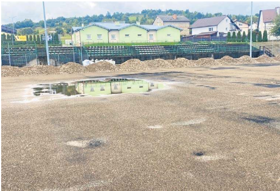
Podczas budowy stadionu w 2008 r. popełniono błędy i dlatego na murawie była woda. Trzeba teraz wykonać nowy drenaż, co skutkuje dodatkowymi kosztami
