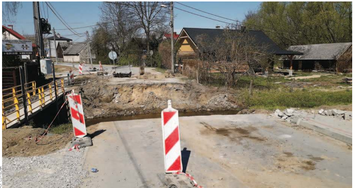
Zdaniem jednego z mieszkańców osiedla Malce, tak ustawione pacholki na pewno nie zabezpieczają przed wypadnięciem do rzeki
